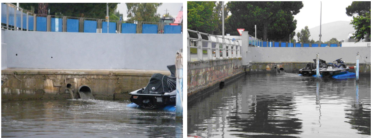
Vertido de aguas residuales a las acequias de la urbanización de Santa Margarita desde la estación central de bombeo del sistema de aguas residuales de la plaza del Estel. Las acequias de Santa margarita desaguan en la red hídrica del Parque Natural
